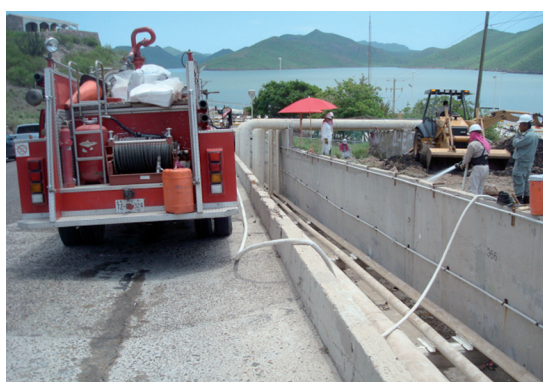
Emergencia en ductos playeros por toma clandestina, Sin.
