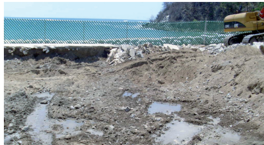
Proyecto clausurado, cuyas obras fueron demolidas. Bahías de Huatulco, Oaxaca
