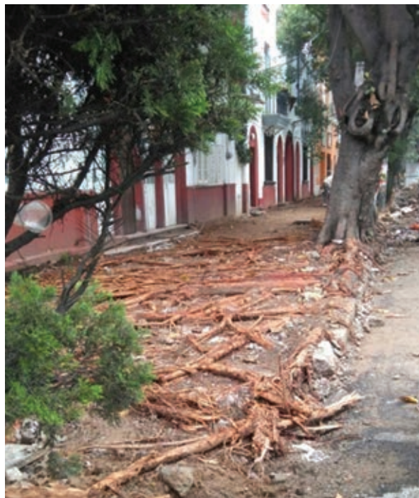
Fotografía 6. Afectación de raíces de árboles por obras de rehabilitación de banquetas en la colonia Roma
