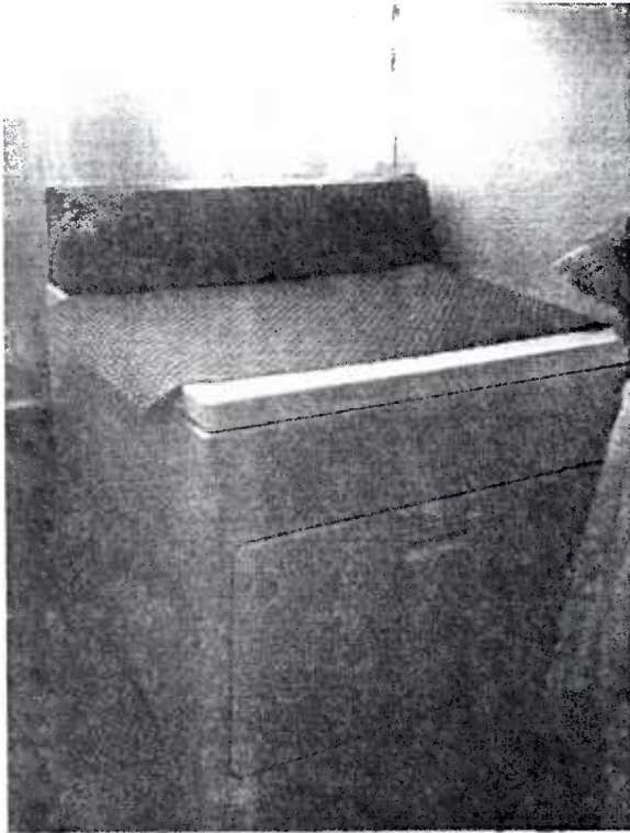
Foto 5. Secadora ROPER modelo RR107J656B0, instalada en el patio de servicio cerrado del Depto. 201. Dispone de un escape trasero, apropiado para espacios limitados.
