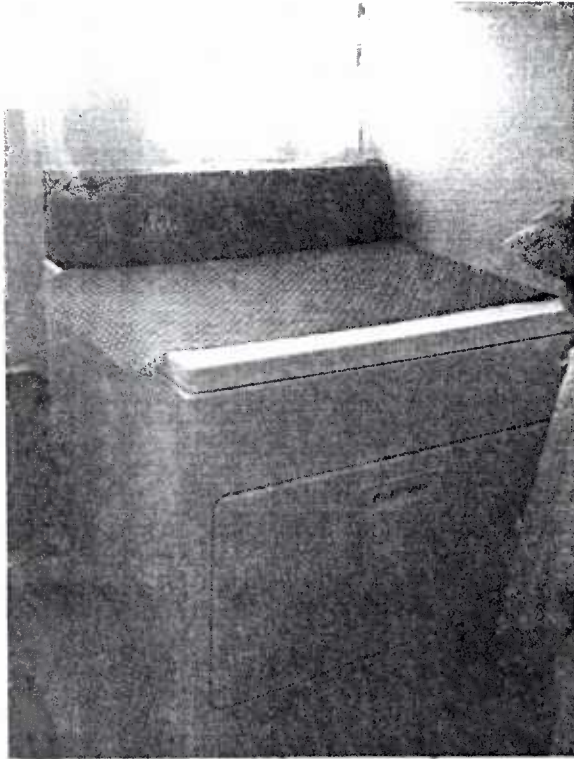
Foto 5. Secadora ROPER modelo RRT07J6S6BO, instalada en el patio de servicio cerrado del Depto. 201. Dispone de un escape trasero, apropiado para espacios limitados.
