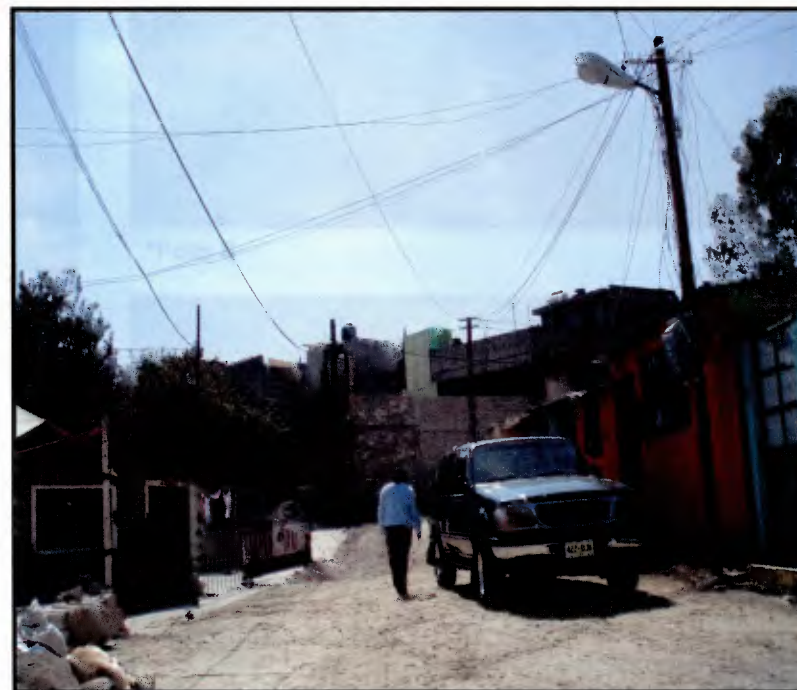
*Foto 4 Tendido de cables sobre palos de madera habilitados como postes, con cajas de luz.
