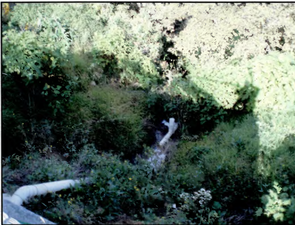
*Foto 8 Tubería de PVC rota que descarga directamente aguas residuales hacia la barranca.
