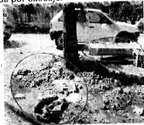
Foto 2.- Poste de concreto y basura
