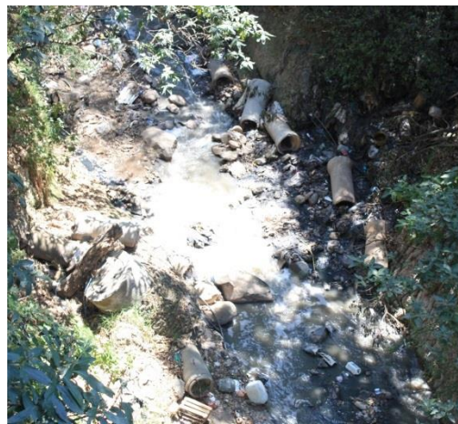
Figura 23. Escombros de obra pública sobre el cauce.
