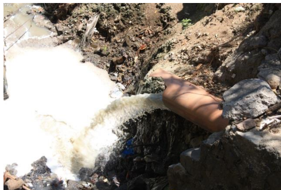
Figura 4. Tubo que descarga agua de drenaje directamente al cauce.
