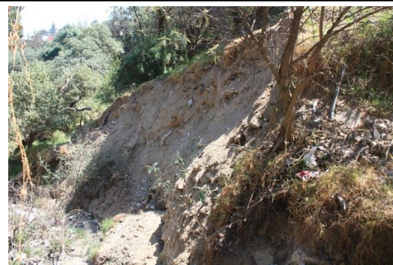
Figura 5. Se resalta la grave erosión de una de las laderas.
