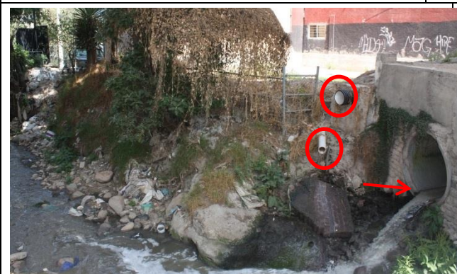
Figura 34. Se muestran varios tubos de descarga que van hacia el cauce.
