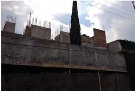
El viernes pasado por la tarde, los sellos en la obra en Farallón 240 fueron retirados. Foto: Archivo
