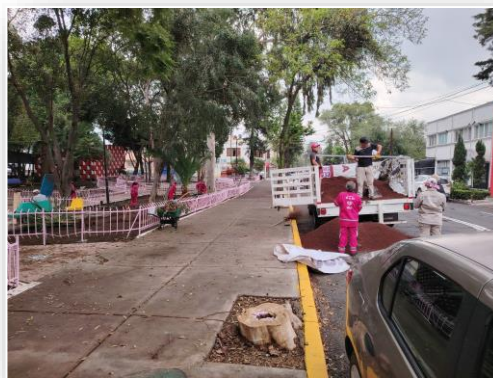
Imagen 15. Personal de la alcaldía Gustavo A. Madero bajando material (gravilla) de un vehículo. La gravilla se observó esparcida en otras jardineras del Parque.
